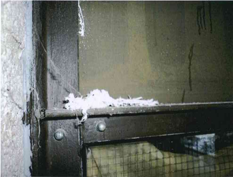
Bild 6: Asbestgewebereste auf Fenster, Aufenthaltsbereich Nichtschwimmer, Lage vgl. Bild 5
