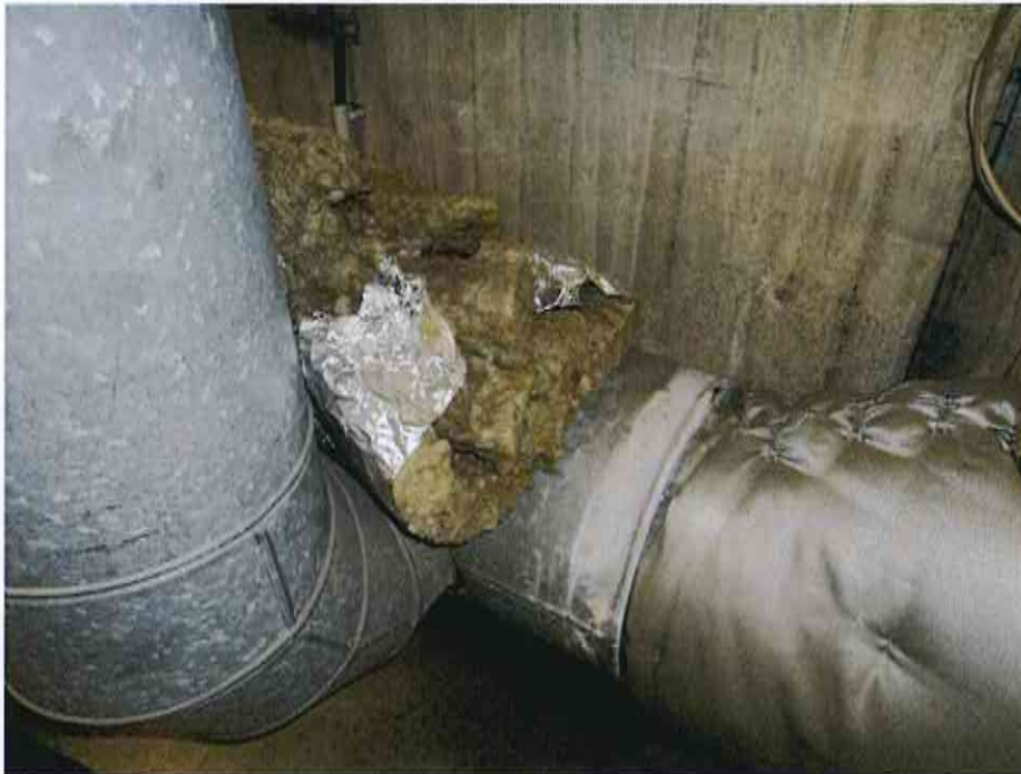
Bild 16: Alte KMF-Isolierung an Heizungsrohren, vgl. Bild 2
