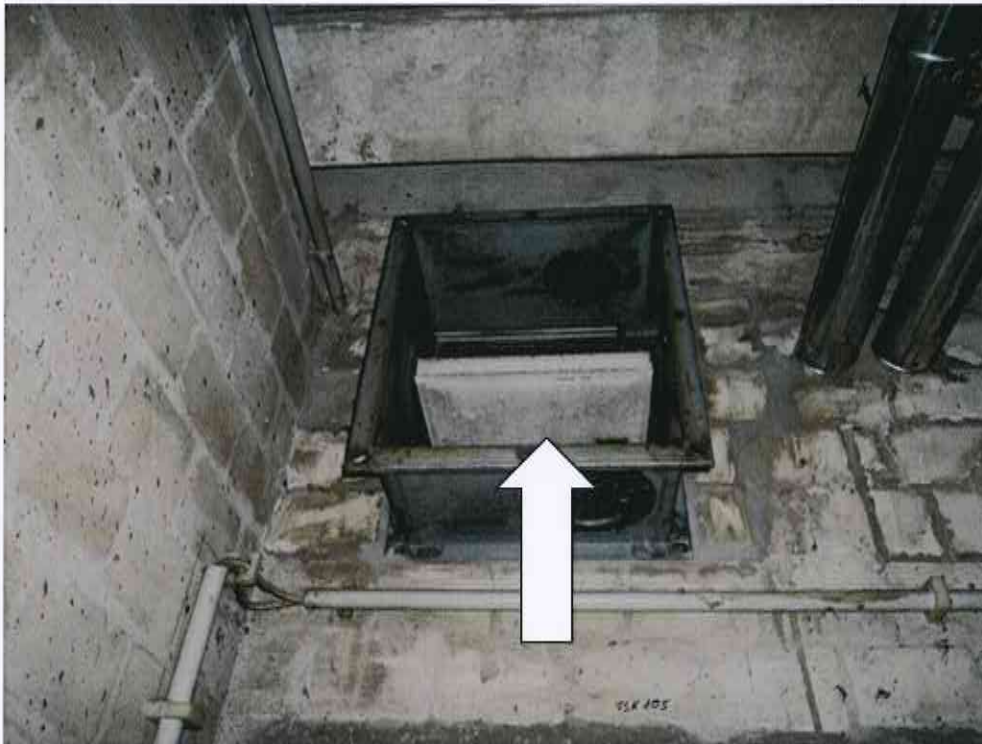
Bild 12: Brandschutzklappe mit asbesthaltigem Klappenblatt, Beispiel
