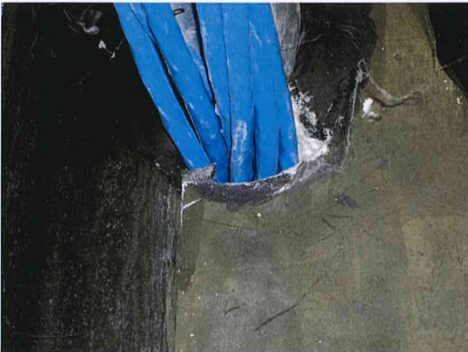
Bild 7: Öffnung in Asbestplatte und plausible Quelle der Reste aus Bild 6.
