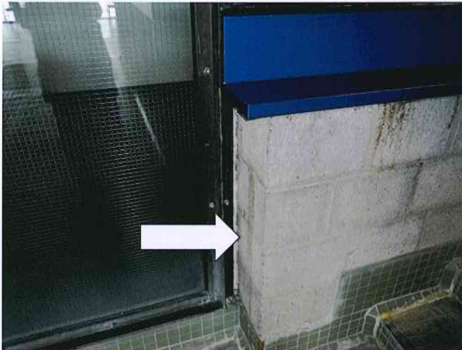
Bild 8: Asbestschnur, Aufenthaltsbereich Nichtschwimmer
