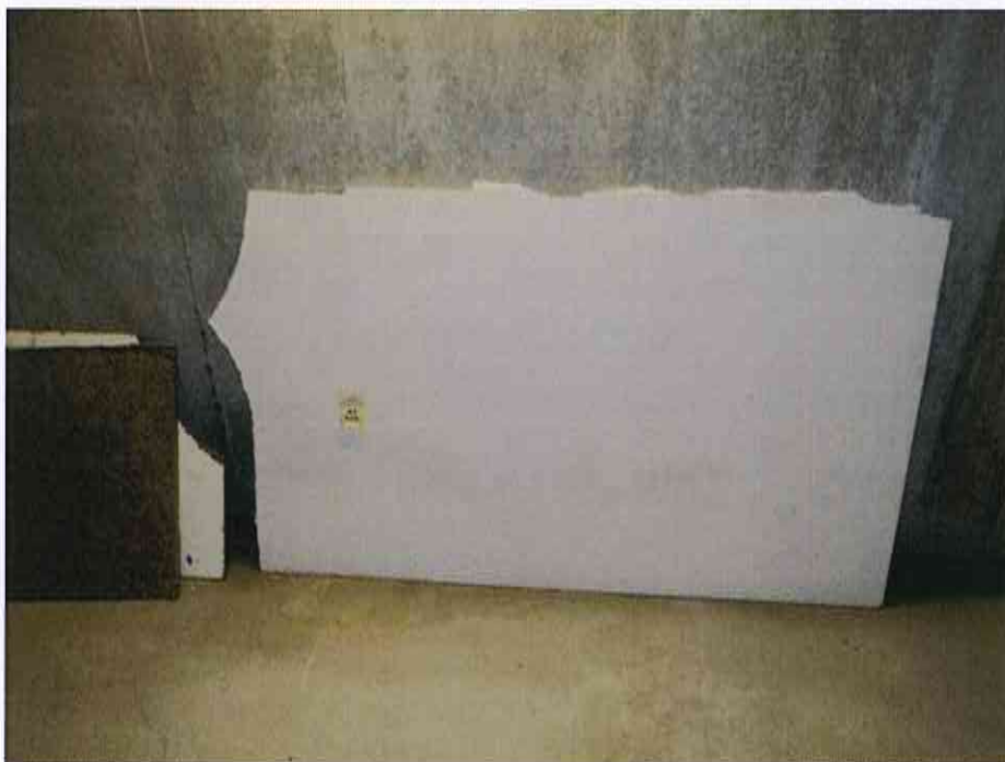
Bild 14: asbestfreier Rest einer Bauplatte, Raum Filter, E 0
