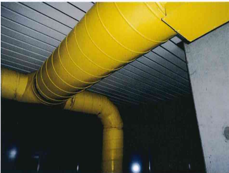
Bild 17: Unterdecke mit KMF-Auflage, Garderobe Tribüne Ebene 2 Unterdecken Sozialräume und Saunabereich baugleich
