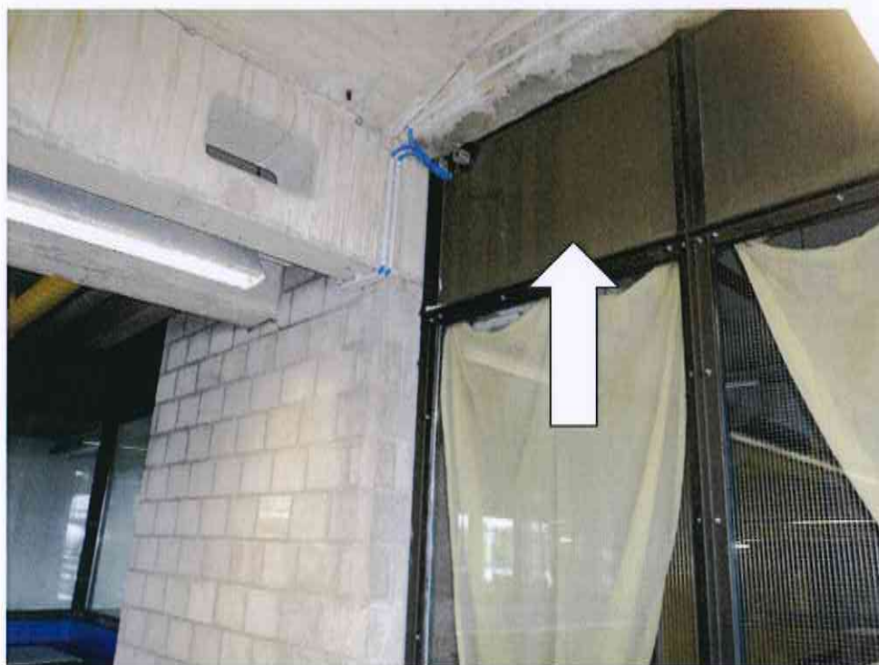
Bild 5: schwach gebundene Asbestplatte in Fensteroberlicht, Nichtschwimmerbecken
