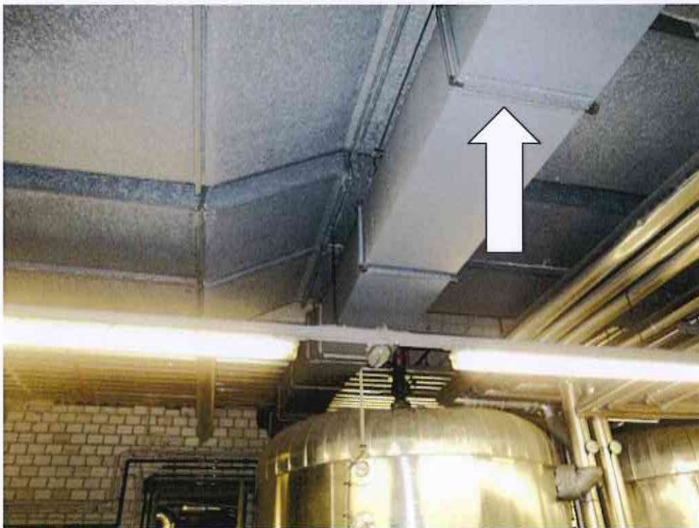
Bild 3: Asbesthaltige Dichtung an Lüftungskanal (Kunststoffkanal)
